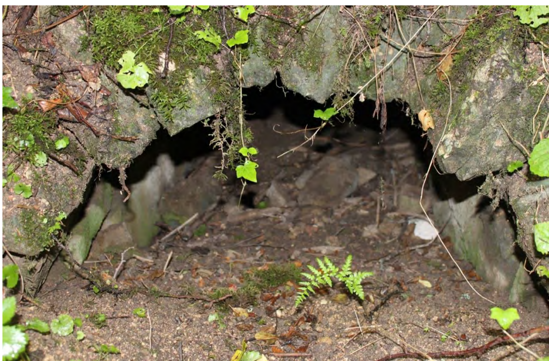
Figure 39 : Souterrains, détail de la voûte en berceau et des claveaux, photos Luc Burnel 2017.
