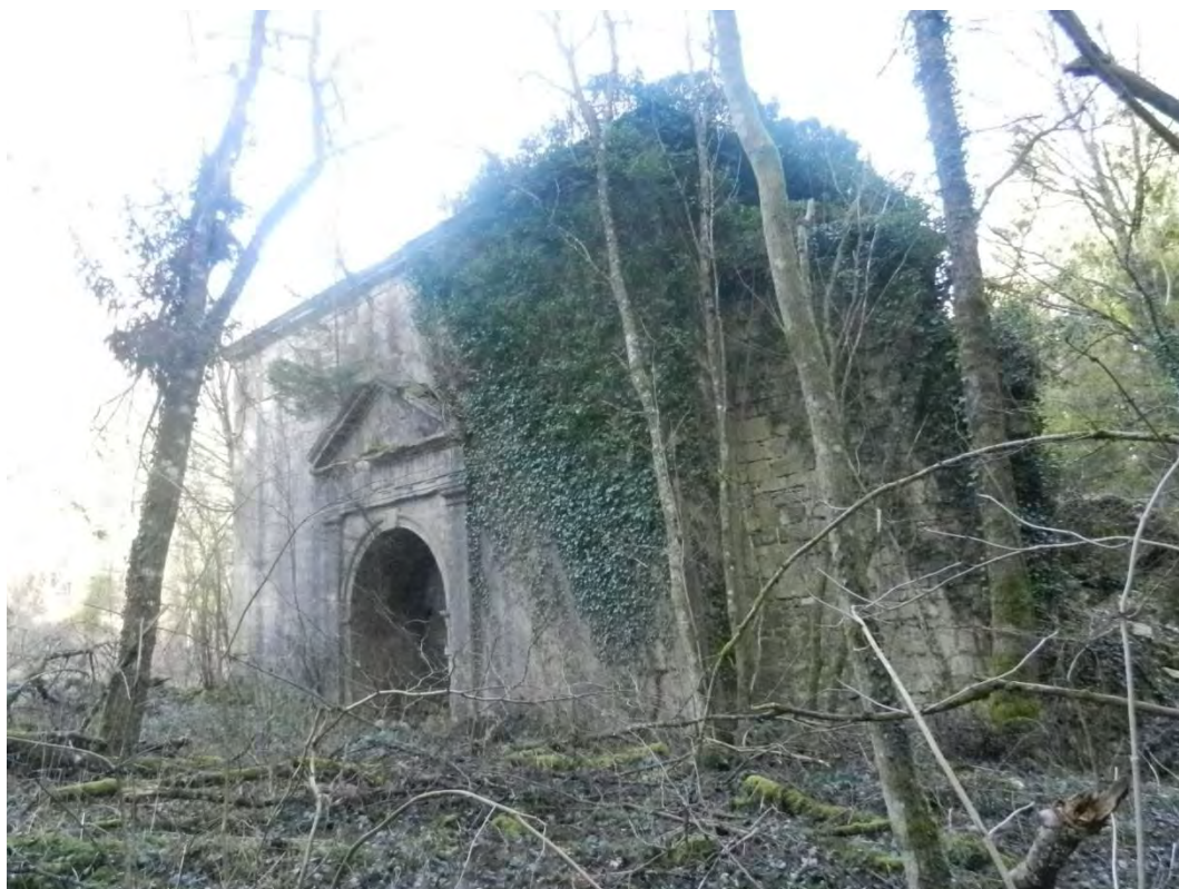
Figures 24 : Etat des maçonneries, omniprésence de la végétation. Photos Bérénice Rondot 2017 et J.M Langard. 2015-2016.
